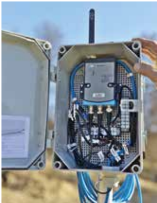
Über LoRaWAN-Knoten können unterschiedliche Sensoren und Aktoren angebunden werden.
